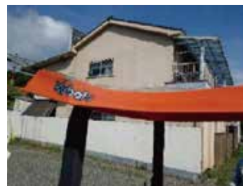
事故による天蓋のゆがみ
